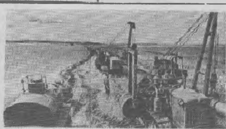
Куйбышевская область. В городе Ставрополе сооружается крупный завод синтетического каучука. В нынешнем году должна войти в строй первая очередь этого завода, который будет вырабатывать из нефтяных газов ценнейшую продукцию. Для обеспечения завода газом прокладывается газопровод протяженностью 91 километр. Строители оснащены современной техникой—трубоукладчиками, ятогудронаторами, изоляционными и другими машинами. Благодаря этому все трудоемкие процессы, начиная от рытья траншей и кончая укладкой в них труб, механизированы. На снимке: машины, работающие на прокладке газопровода на участке № 6.
