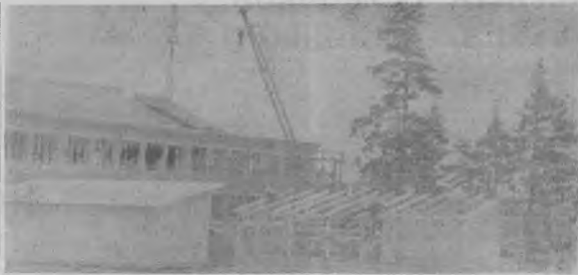
НА СНИМКЕ: детский комбинат на 140 мест в благоустроенном квартале 9—11 поселка Буланаш-3. Строители уже приступили к отделочным работам. К празднику Октября дети справят новоселье.
