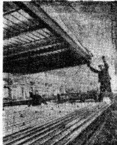
КЕМЕРОВСКАЯ ОБЛАСТЬ. Кислородно-конвертерный цех № 2 Западно-Сибирского металлургического завода имени 50-летия Октября строится страна.
