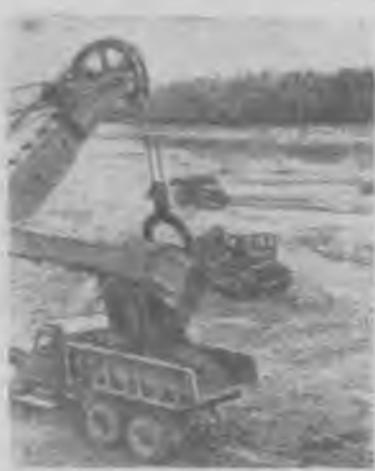
На берегу Даугавы сооружается Плявиньская ГЭС. Строители обязались к дню открытия XXII съезда КПСС закончить подготовку котлована и начать закладку фундамента плотины.
