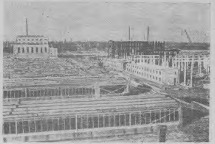
На правом берегу Камы недалеко от Камской ГЭС раскинулась огромная строительная площадка. Здесь сооружается крупный кабельный завод. Один из его корпусов уже сдан в эксплуатацию.
