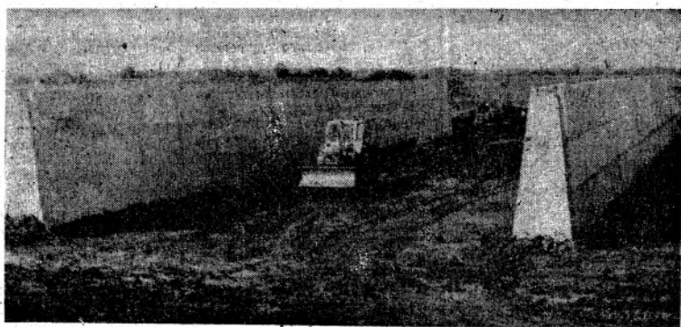
Надежным сооружением для хранения сочных кормов являются наземные силосные траншеи. Впервые они появились в нашем районе в прошлом году в Сарафановском отделении совхоза «Егоршинский». Такие силосные сооружения долговечны, надежны. В них значительно лучше сохраняются законсервированные зеленые корма.
