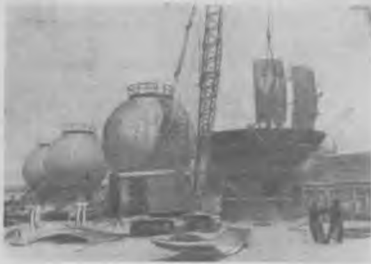
Азербайджанская ССР. На строительстве бутановой группы цехов Сумгаитского завода синтетического каучука сооружаются паровые емкости. Каждый стальной шар монтируется из отдельных сегментов. Эту сложную работу выполняет бригада монтажников участка "Стальконструкция", возглавляемая Иваном Пешетовым. Ее коллектив, внедривший в производство несколько рационализаторских предложений, выполняет нормы на 150 процентов. На снимке: монтаж шаровых емкостей.
