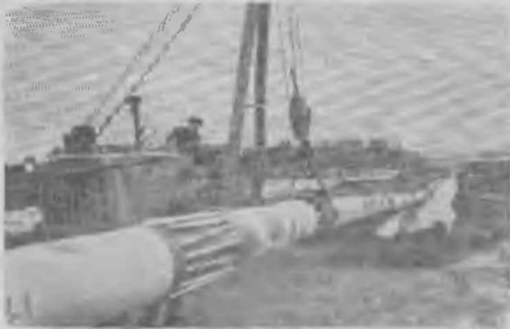
Воронежская область. На территории области ведется прокладка второй нити газопровода Ставрополь—Москва. Самый сложный и трудный участок на сооружении трассы — пойма и русло реки Тихая Сосна в районе города Острогожска.
